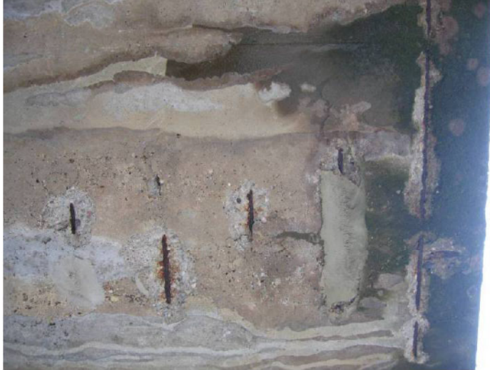
Roestende wapeningen in het beton aan de onderkant van de inkomluifels.
