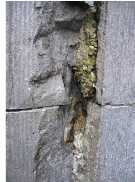
Roestende wapeningen in het beton achter de natuurstenen sokkel zwellen op en breken de natuursteen.
