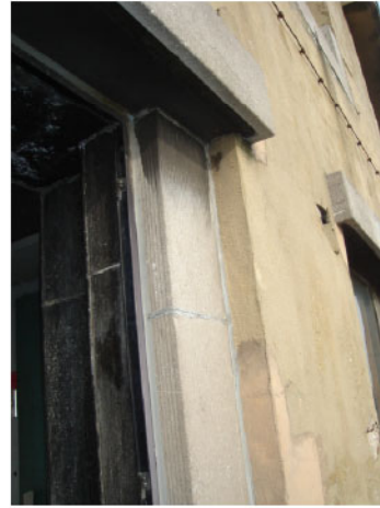
afbeelding 3: ernstige schade door betonrot aan de gevel bestaande herstellingen in epoxymortels.
