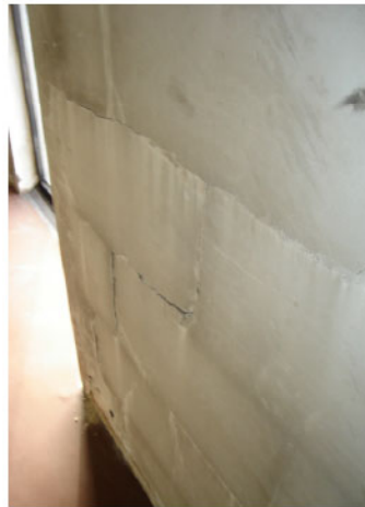
afbeelding 2: binnenwand in slechte staat (enkel t.p.v. de toren)
