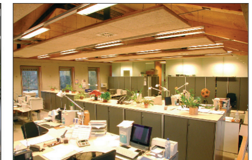
absorptie in grote velden afgehangen van het plafond; technieken ertussen
