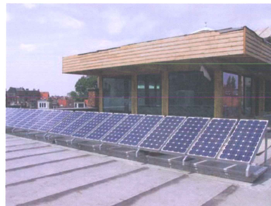
ECOHUIS te Borgerhout – Zonnepanelen op het dak.
