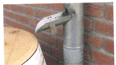
05_Opvang regenwater bij de woning
