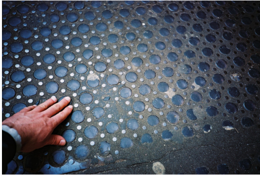
Fig 9. Kelderverlichting glas in asfalt
