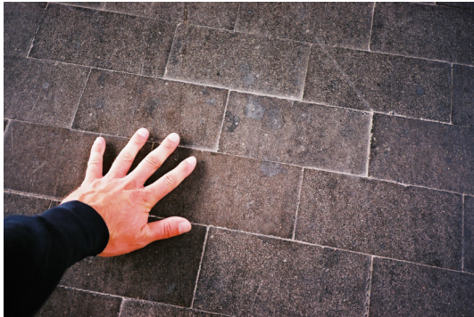
Fig 3. Vloer gepolijste asfalttegel
