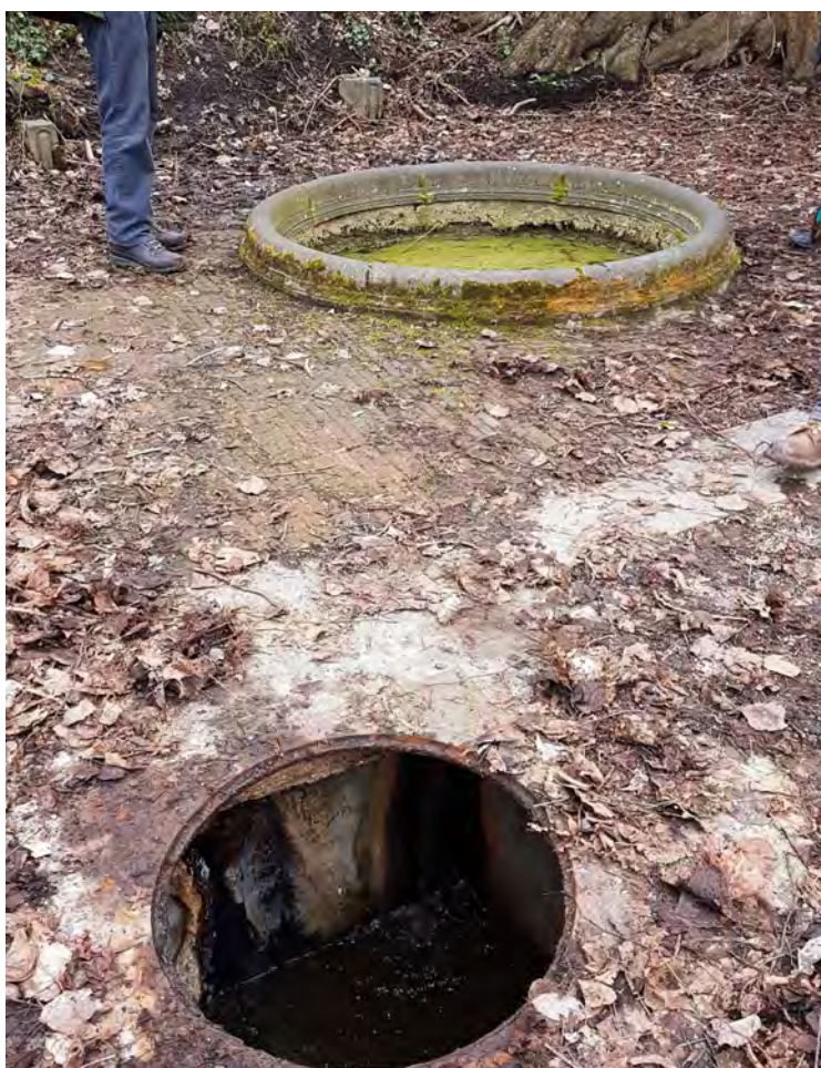
Bron in Maloupark eindigt in rioleringsnet foto: vzw Coördinatie Zenne
